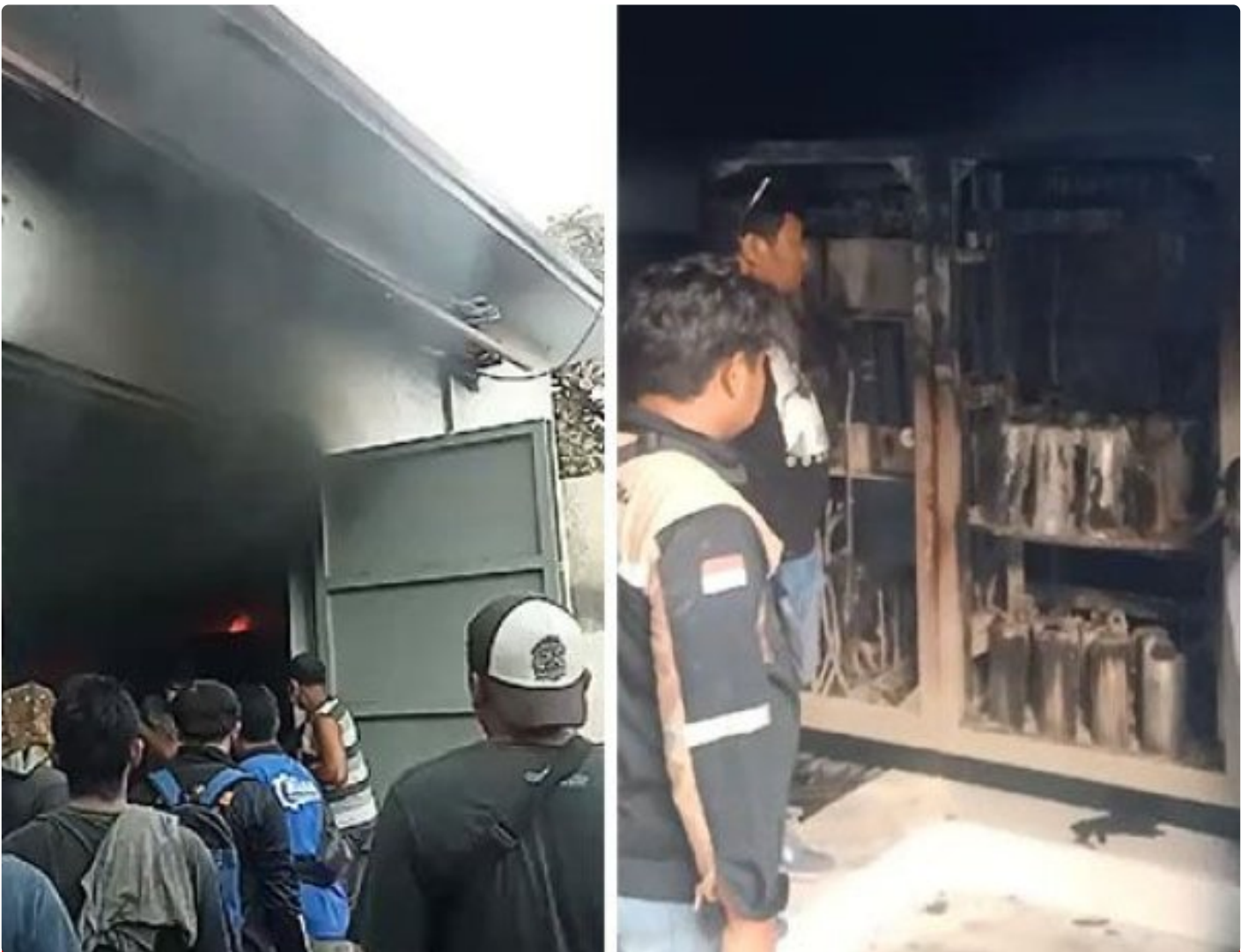
Pabrik penggilingan padi Ratu Pangan Sejahtera di Kabat terbakar
